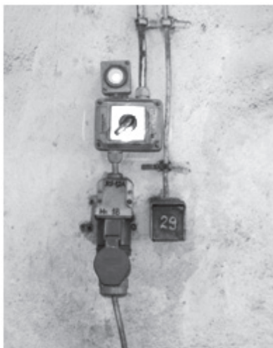
Rys. 3. Sygnalizator poboru prądu umieszczony przy gnieździe siłowym [opracowanie własne]
